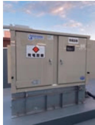
名鉄トラックターミナル関西では、BCP対策として、停電時に対応する自家発電装置を設置
