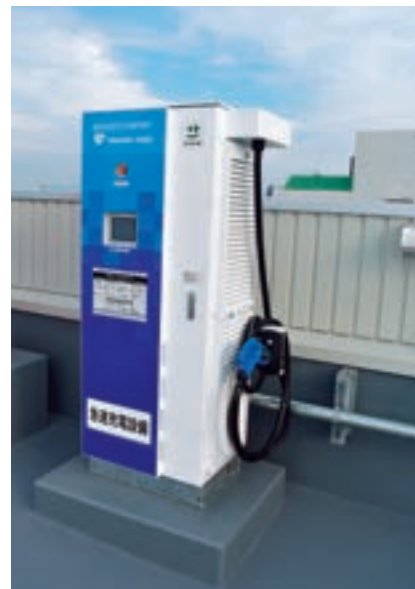
EV充電設備
